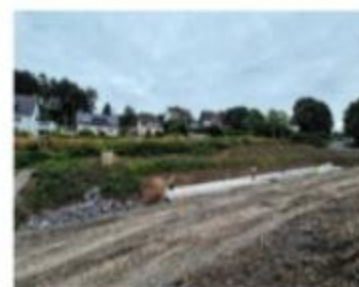
Das Niederschlagswasser aus dem Wohngebiet Altenberg wird hier abgeleitet und landet dann in dem Rückhaltebecken.
